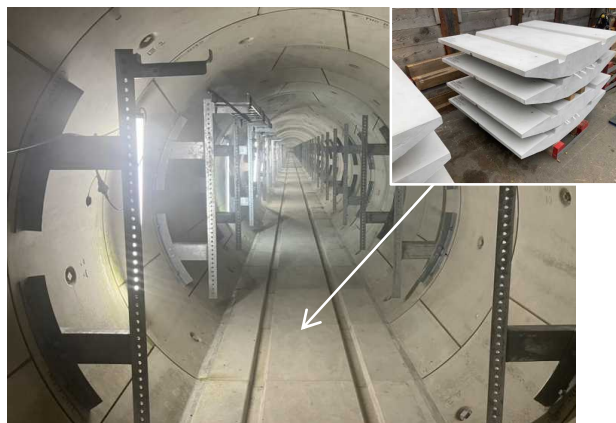
<据付後の状況>
